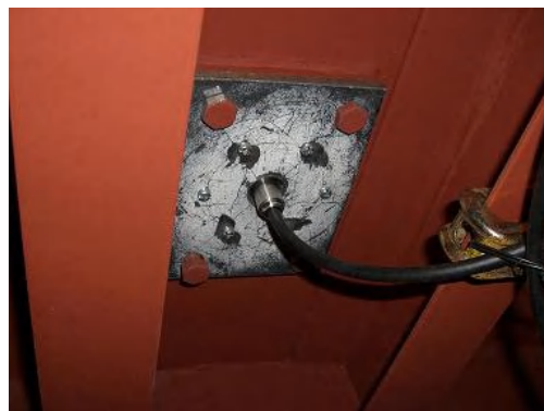
圧力センサー(型枠内側)
